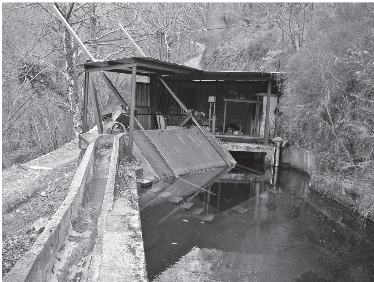
Figure 5. An automatic rake to prevent OM entering the turbines in a small hydropower plant in Añarbe Stream, the Basque Country, Spain. Una rejilla automática para evitar la entrada de materia orgánica a las turbinas de una pequeña planta hidroeléctrica en el arroyo Añarbe, País Vasco, España.
